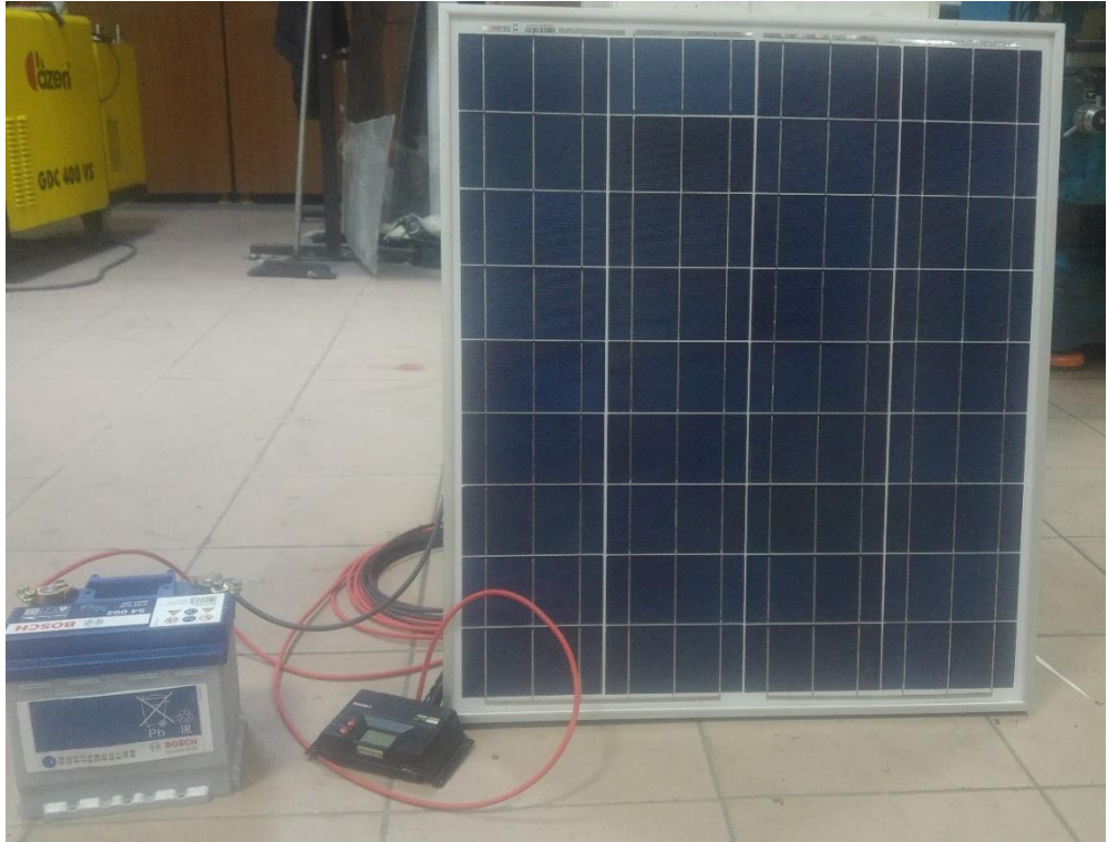
Şekil 5.3 Sistemin Güneş Paneli Ve Akü Montajı
